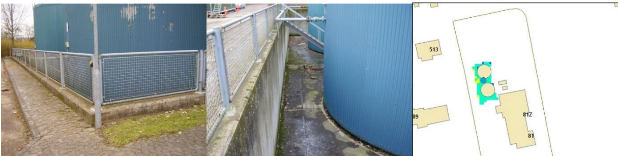
Figur D7: ca. 2 meter ned ved siloerne, ca. 25 cm kant omkring siloerne. Kanten er ikke beskrevet i DTM data pga. dataopløsningen på 1.6 m, men i hydraulisk sammenhæng, er den vigtig idet vandet ikke ville være løbet ned i silograven.
