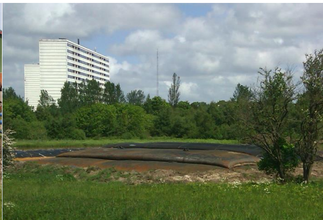
Figur 6-15: Afvandingspose i brug
