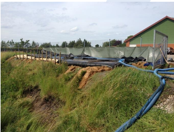
Figur 6-14: Afvandingspose i brug
