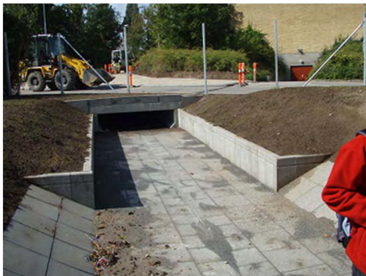
Figur 6.10 Aflastningskanal til reduktion af oversvømmelser ved Idrætsparken i Odense, etableret i 2008.
