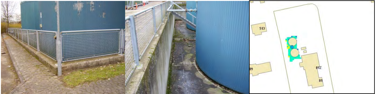
Figur G.7 Ca. 2 m ned ved siloerne, ca. 25 cm kant omkring siloerne. Kanten er ikke beskrevet i DTM data på grund af dataopløsningen på 1,6 m, men i hydraulisk sammenhæng er den vigtig, idet vand ikke ville være løbet ned i silograven.
